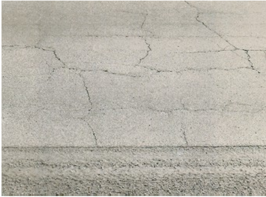
Figure 2.7.1(d) Light Map Cracks
