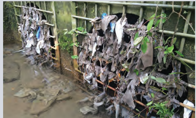
Débris provenant d'un débordement d'eaux usées accrochés à une grille qui recouvre un tuyau d'écoulement.
