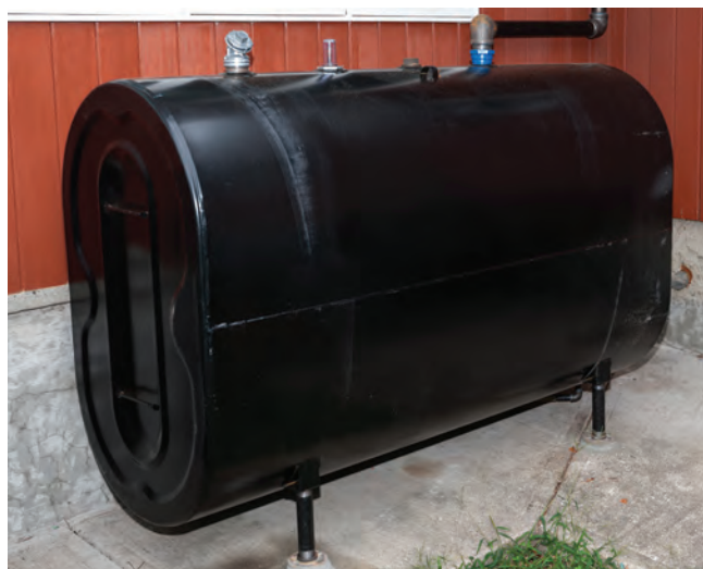
Exemple de réservoir extérieur de stockage de combustible au-dessus du sol.
