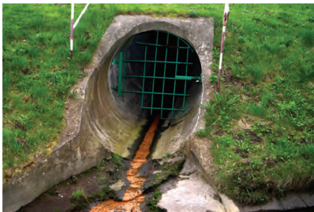
Canalisation de rejets d'effluents.
