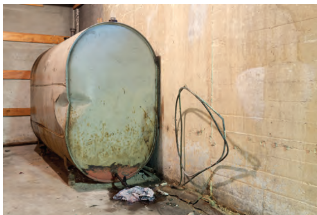
Exemple de réservoir de mazout de chauffage résidentiel mal entretenu dans un sous-sol.
