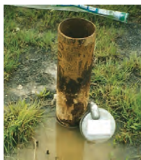
Puits d'approvisionnement en eau mal entretenu.
