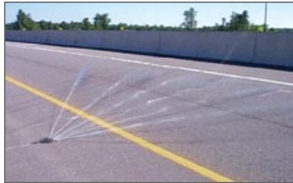
Système FAST d'un tablier de pont
