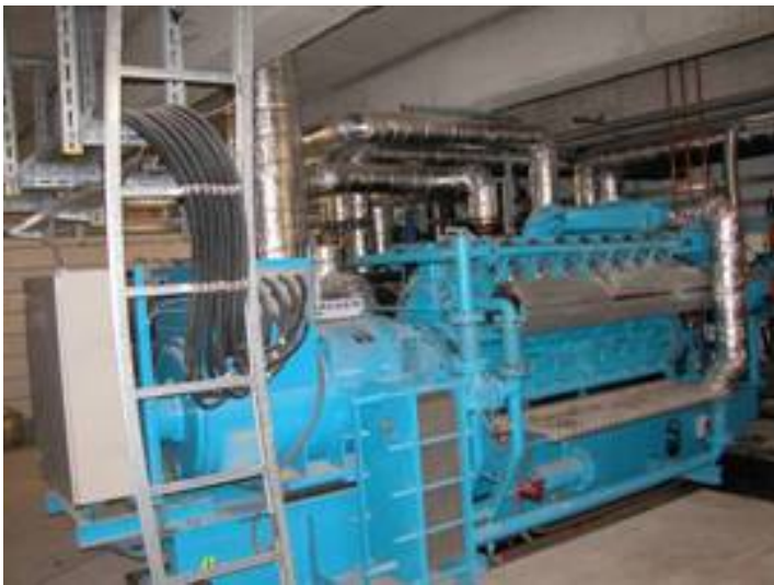
Figure 2 : moteur diesel Jenbacher
