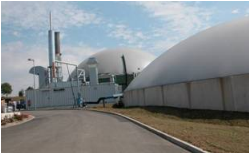
Figure 5 : installation de production de biogaz
