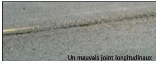
Un mauvais joint longitudinal
