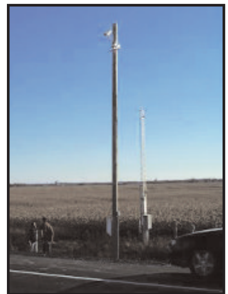
Zone contrôlée par un capteur de SMR
