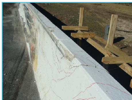
Fissures de la glissière à la suite de l'essai de choc avec un semi-remorque
