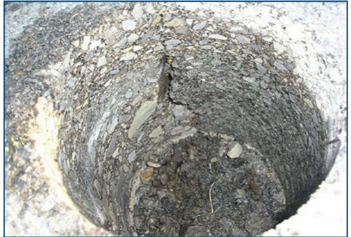
Propagation d'une fissure vers le haut
