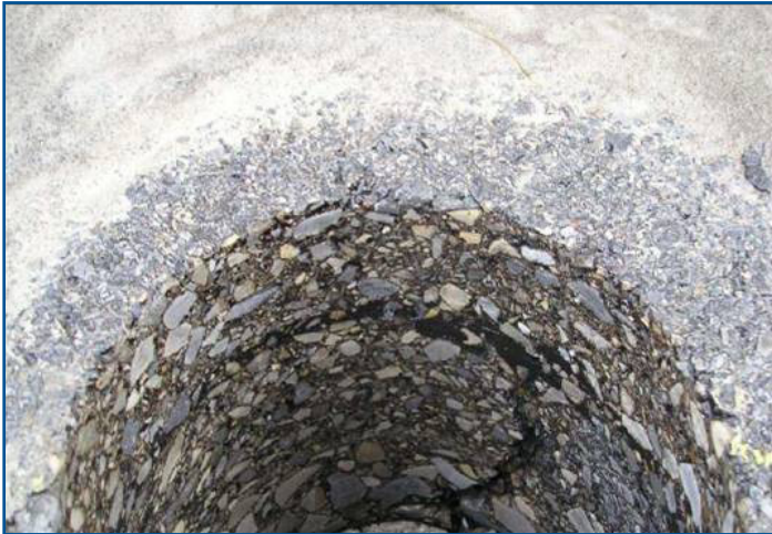
Aucune propagation de fissure visible dans le trou de carottage après utilisation de la couche renforcée de fibres.
