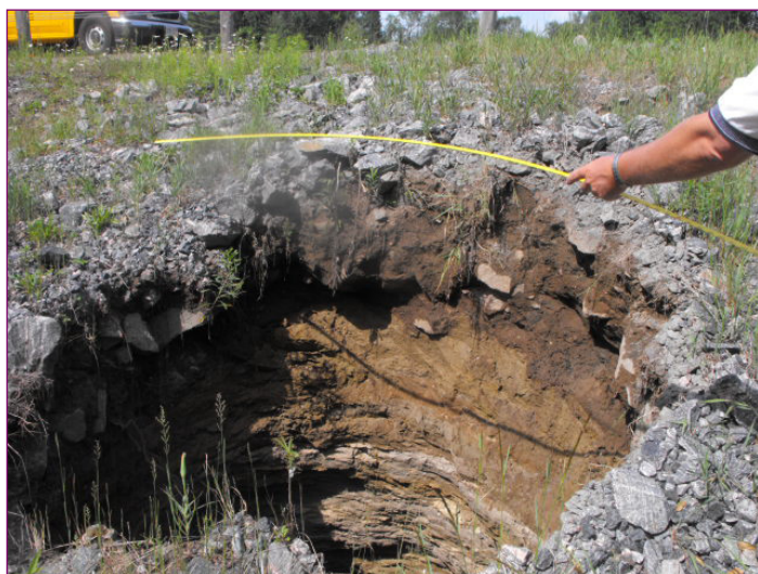
Figure 2 : Une doline se développant dans le remblai menace l'intégrité de la voie direction nord adjacente sur la route 11.
