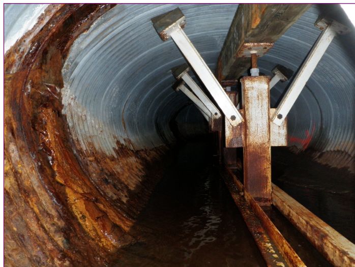
Figure 3 : Deux sections du tuyau d'acier ondulé ont été contreventées en 2009 afin de prévenir tout déplacement
