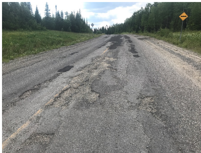
Exemple de chaussée endommagée.
