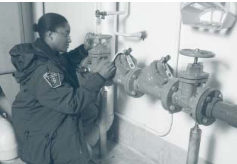
Un inspecteur du MEO vérifie le dispositif anti-refoulement et l'intégrité du clapet
