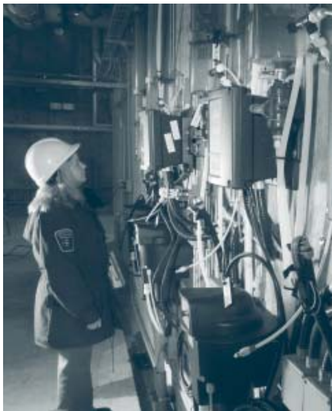
Inspection des cadrans à affichage numérique des appareils de surveillance continue
