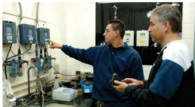
Des préposés observent un écran en ligne qui montre le chlore résiduel.
