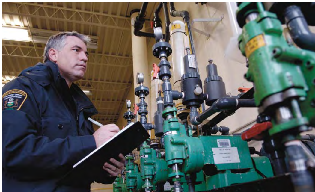
Un inspecteur vérifie si une pompe à produit chimique (sulfate d'aluminium ou « alun ») administre le dosage pertinent.
