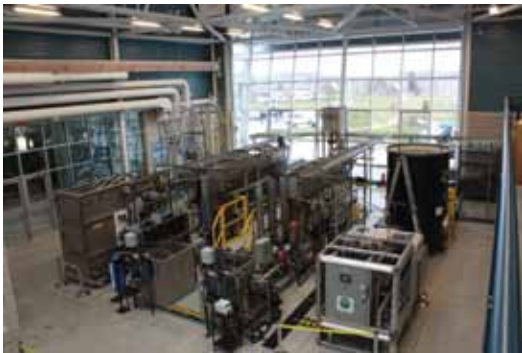
Vue de l'installation de démonstration technologique.
