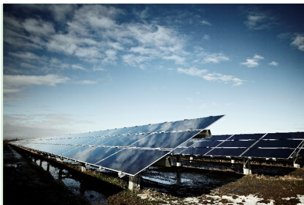
Centrale solaire à Sarnia.
