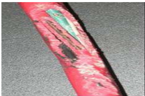
Figure 1. Traces de grignotement sur des fils électriques.
