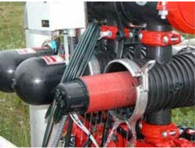
Figure 1: Intérieur du filtre à disque
